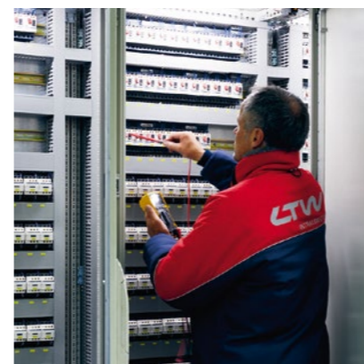
Der Aufwand für penible Ordnung in allen Schaltschränken und Kabelkanälen erweist sich später bei der Wartung und Fehlersuche als hilfreich.
