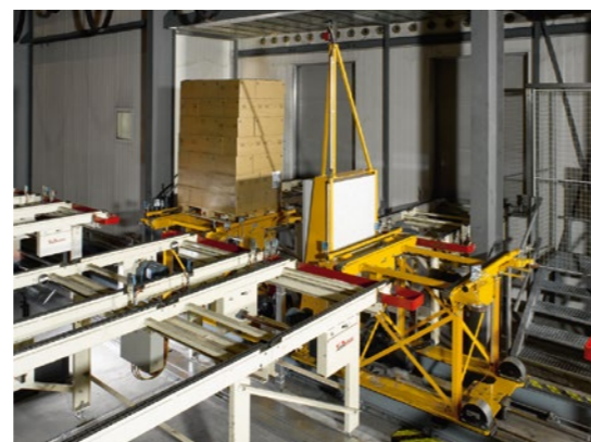
Der neue, schnellere Doppel-Verschlebewagen behebt 2007 ein Nadelöhr in der Fördertechnik und läuft seither dank vorbeugender Wartung reparaturfrei.
