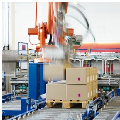
Der bestehende Roboter wird mit exaktem Timing und minimaler Betriebsunterbrechung in die neue, vollautomatische Kartonfördertechnik integriert.
