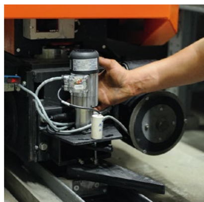
Aktuelle Weichentechnik 2009 mit erneuertem Schaltkeiltrieb und Schaltkeil. Die Weichen sind verschleißarm ausgeführt.
