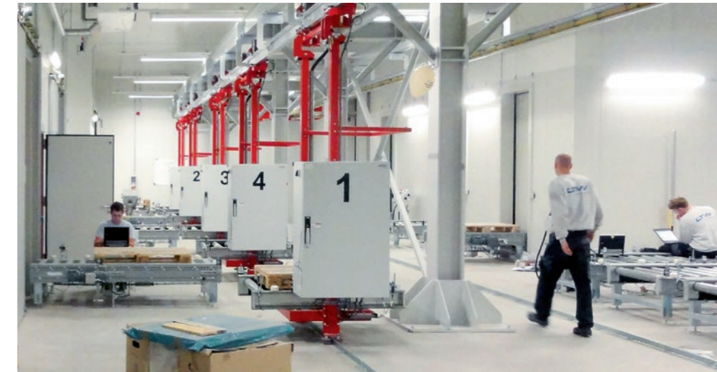
Integration einer Elektrohängebahn (EHB) durch das LTW-Team. Der Hauptvorteil der EHB liegt in der Skalierbarkeit – Fahrzeuge können bei einer zukünftigen Erweiterung des HRL einfach hinzugekauft, bei reduziertem Anlagenbetrieb ausgeklinkt, bei einer Reparatur einzeln in den temperierten Wartungsbahnhof geschoben werden.
