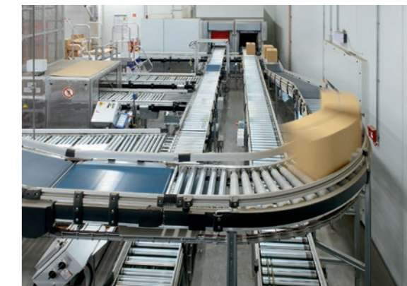
Das Automatische Kleinteilelager und die fördertechnische Verbindung zur Kommissionierzone sind für eine Vielfalt unterschiedlicher Behältergrößen und -qualitäten ausgelegt.
